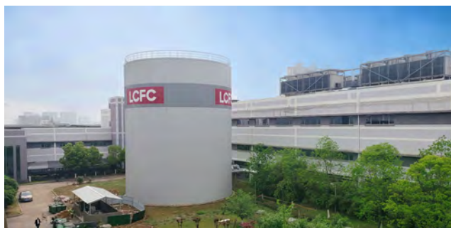
图4 水蓄冷罐现场图
